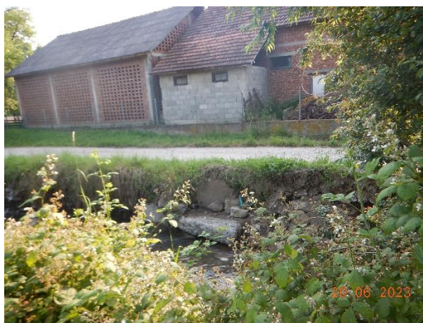
Слика 5 - Оштећење обалске стране у доњем току Лучићке реке
