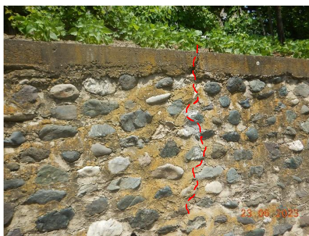
Слика 16 - постојеће пукотине на обложном зиду
