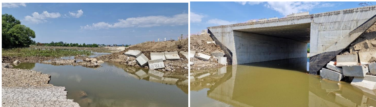
Фото – Карактеристична задржавања воде у зонама градилишта будуће трасе аутопута Моравски коридор, нај-јун 2023. год. (фото – Цивилна заштита града Краљева)
