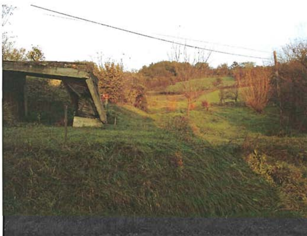
Слика 7. Појаве истрбушавања у телу старог клизишта и порушени помоћни објекат, 300m испод домаћинства Поповић Миломира (фото К.Андрејејев)
