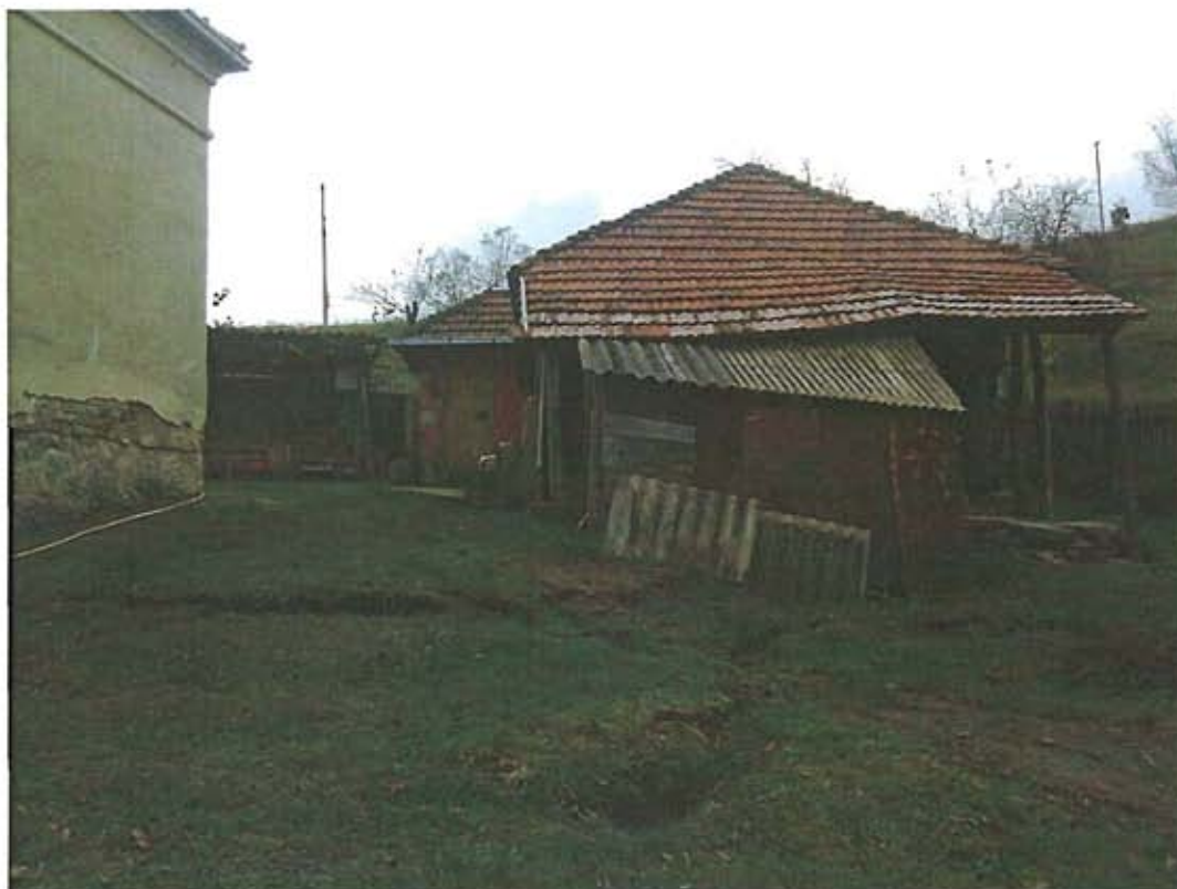
Слика 6. Ожиљци и пукотине у дворишту власника и оштећени помоћни објекти (фото К.Андрејев)
