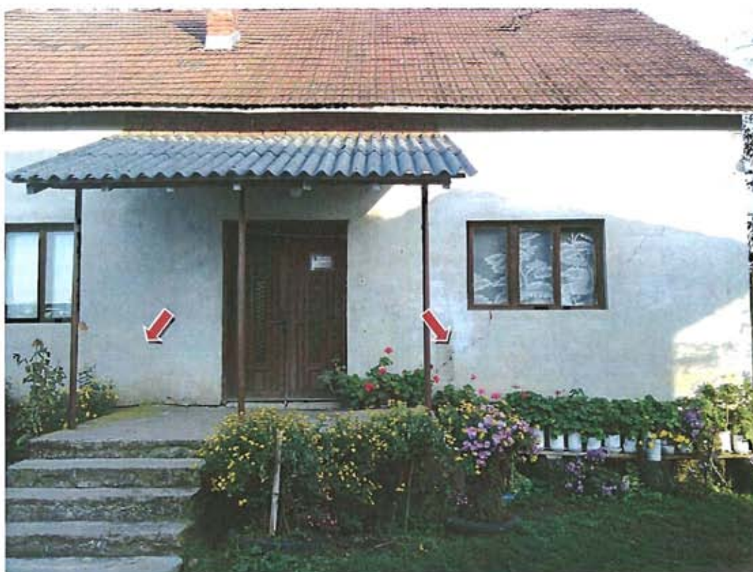
Слика 3. Деформације на објекту последица земљотреса (фото К.Андрејев)
