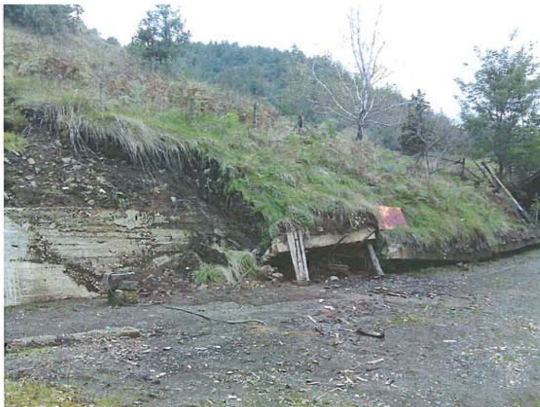
Слика 6. Оштећен и порушен потпорни зид (фото К.Андрејев)
