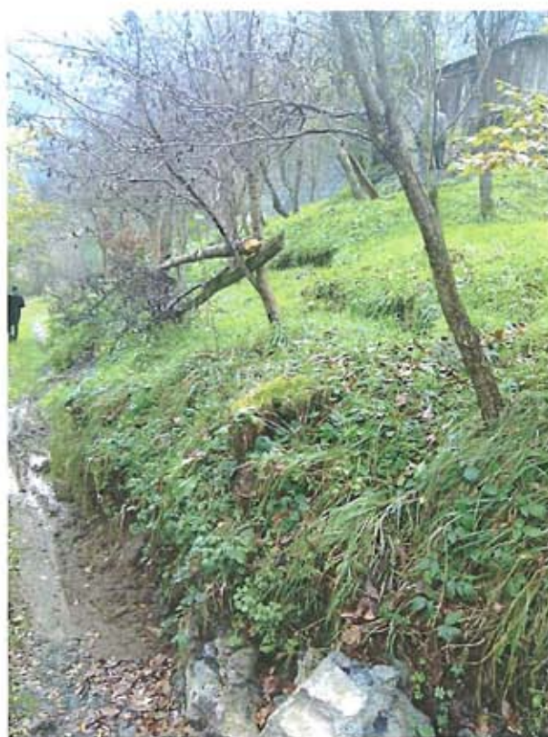
Слика 7. Порушен зид у косини пута под притиском земљасте масе (фото К.Андрејев)
