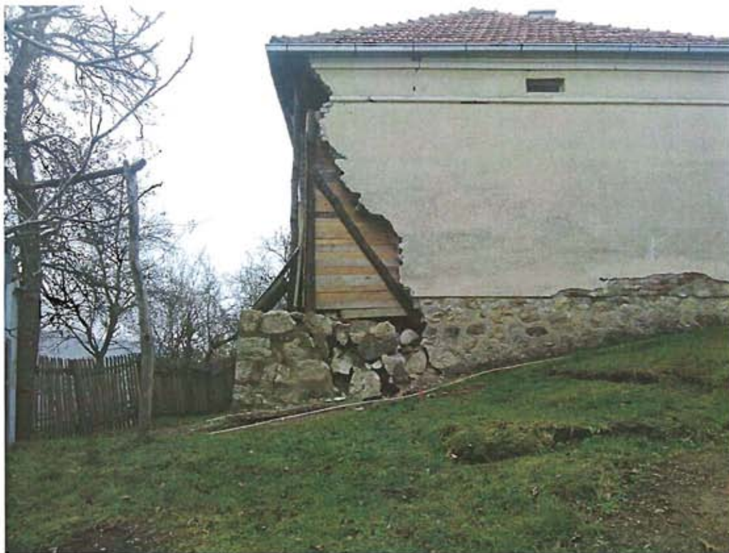
Слика 7. Оштећен темељ и порушен део објекта (фото К.Андрејев)
