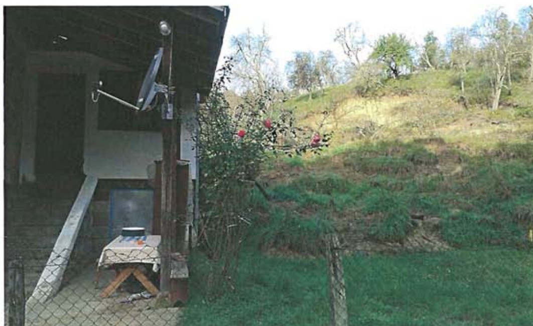
Слика 5. Наклизао материјал до ивице куће Павловић Милице (фото Д. Јевремовић)
