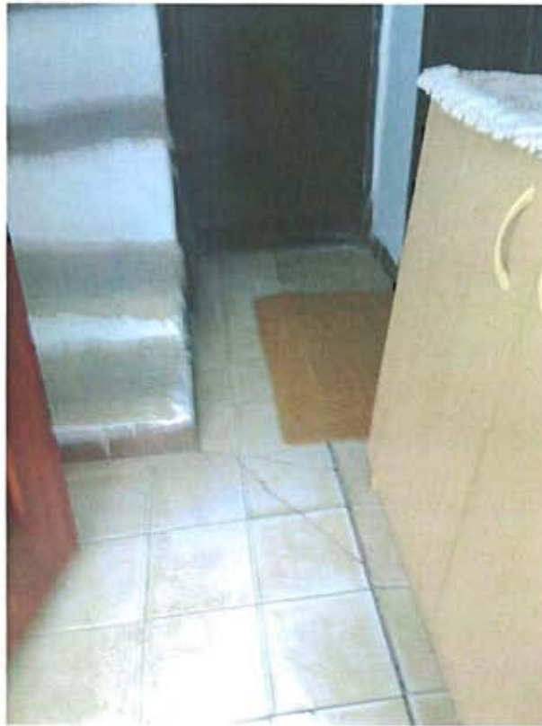
Слика 3. Издигнута емељна плоча услед клижења (фото К.Андрејев)
