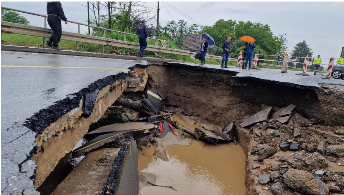
Фотографија 4 – штете на делу Ибарске магистрале у насељеном месту Адрани, прелаз преко Мусине реке, десна притока Западне Мораве (извор: Цивилна заштита Краљево)
